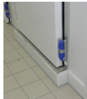
Seuil de chambre froide
